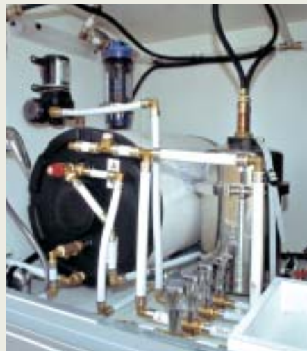
Aufwändig: Wasserkreisläufe mit Filter.
