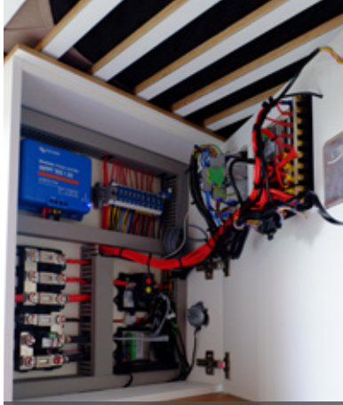
Ein-G-setzt: Die Elektrikzentrale hinter dem Bedienpanel ist gut zugänglich.
